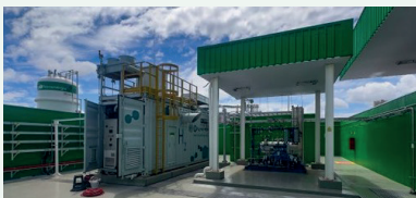
Planta de produção e posto de abastecimento de hidrogênio verde
